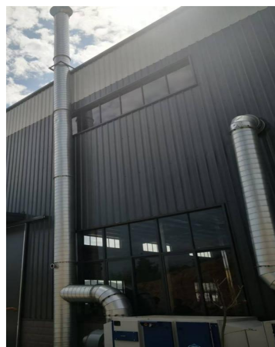
喷漆废气排气筒
