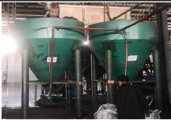
整形工序物料密闭料仓粉尘收集管道
