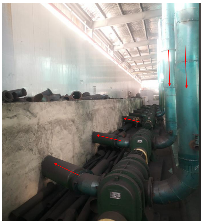
废气管道收集（整形和粉碎工序）
