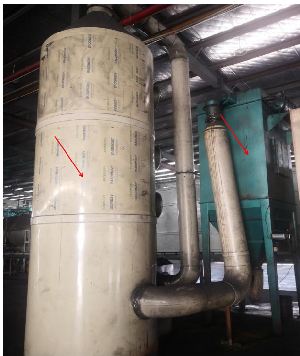
布袋除尘器+水喷淋塔（碳化废气）
